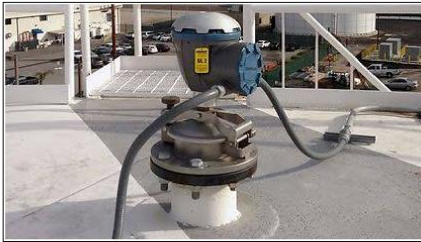
Figure VI. 17 Le jaugeur radar
