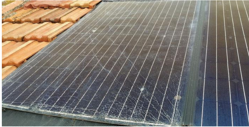
Figure II.15. Module photovoltaïque présentant des bris de verre. [33]
