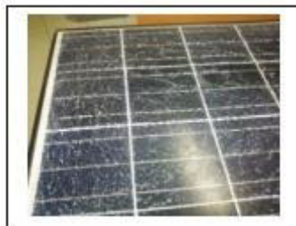
Figure II. 14 : Module photovoltaïque présentant des bris de verre.
