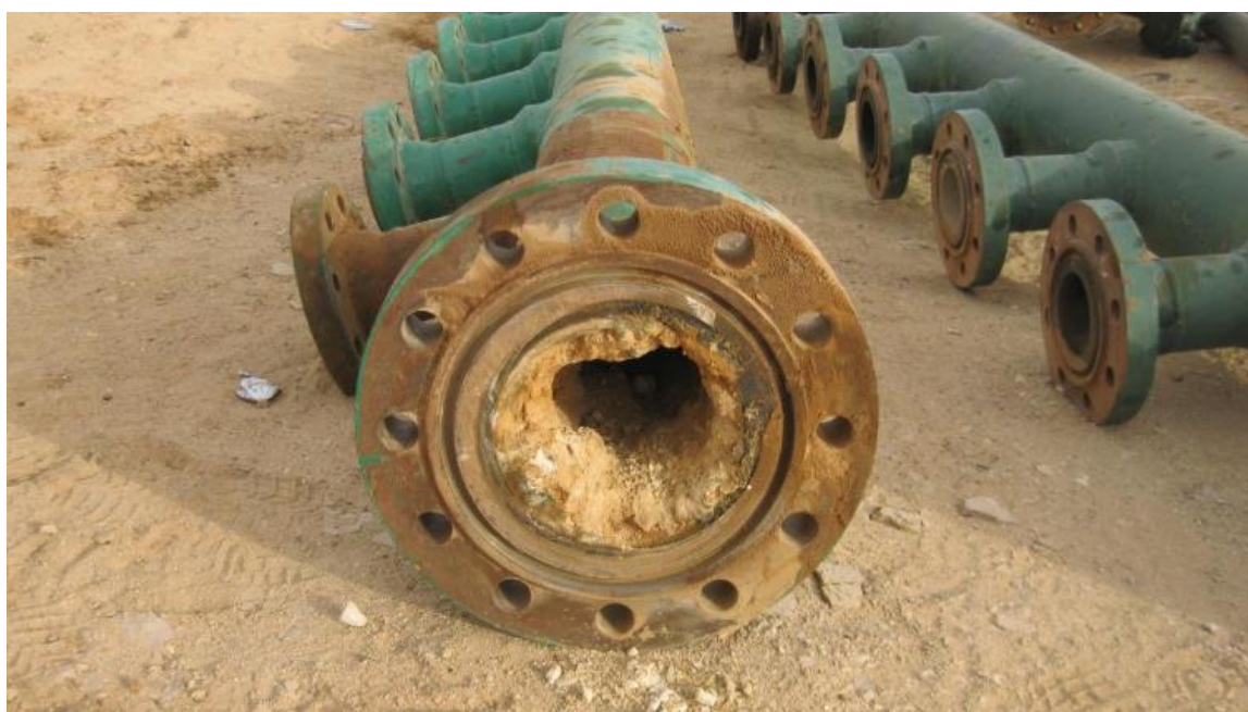
Figure I- 6 : Photographie d'une pipe bouchée par le dépôt BaSO_4 .
