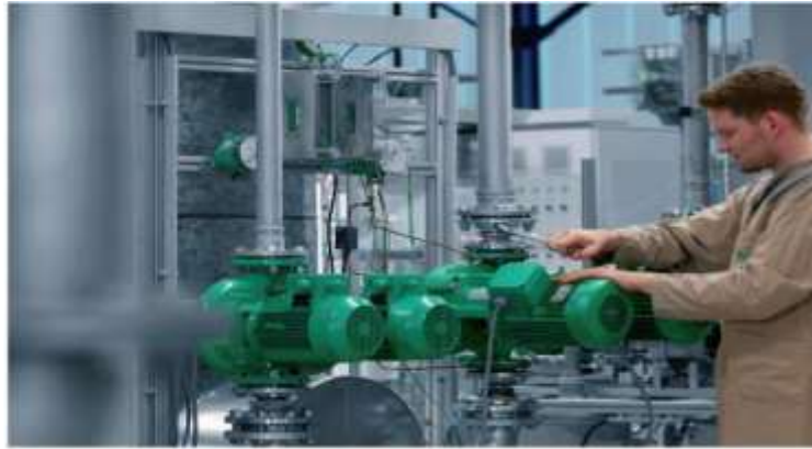
Figure 2.3 : Photo des pompes [5].
