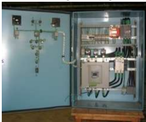
Figure 3.20 : Photo d'une armoire de commande [14].
