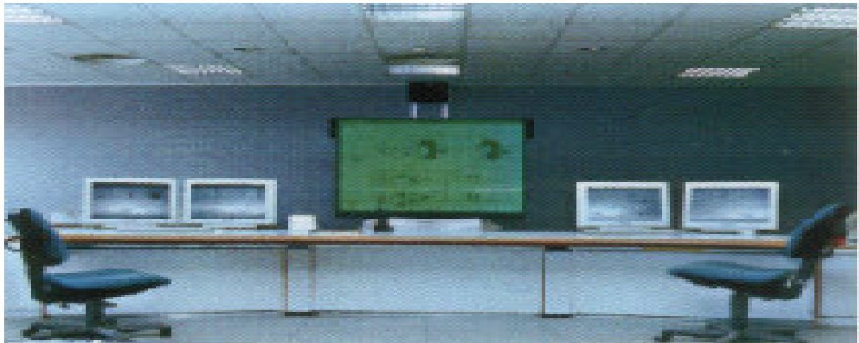
Figure (I.2) : Salle de commande
