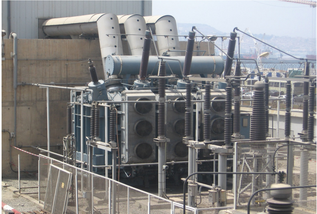
Figure (I.8) : vue externe de transformateur principal
