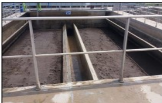
Figure N° 14: Filtre à sable à l'arrêt.
