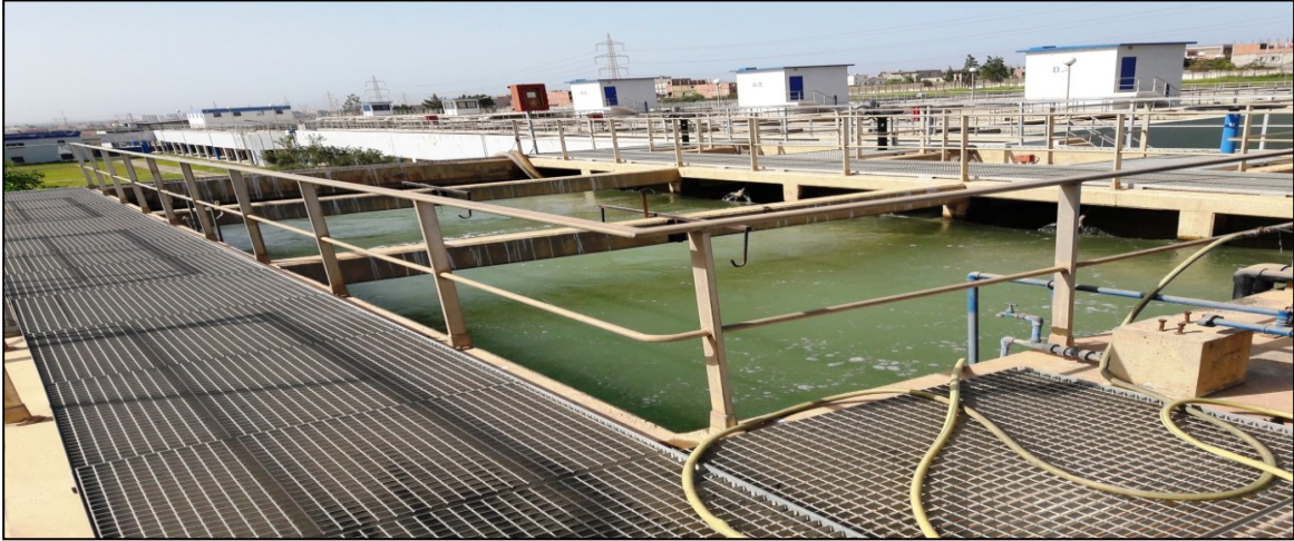
Figure N° 9: Chambre de répartition
