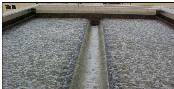
Figure N° 13: Filtre en phase de lavage.
