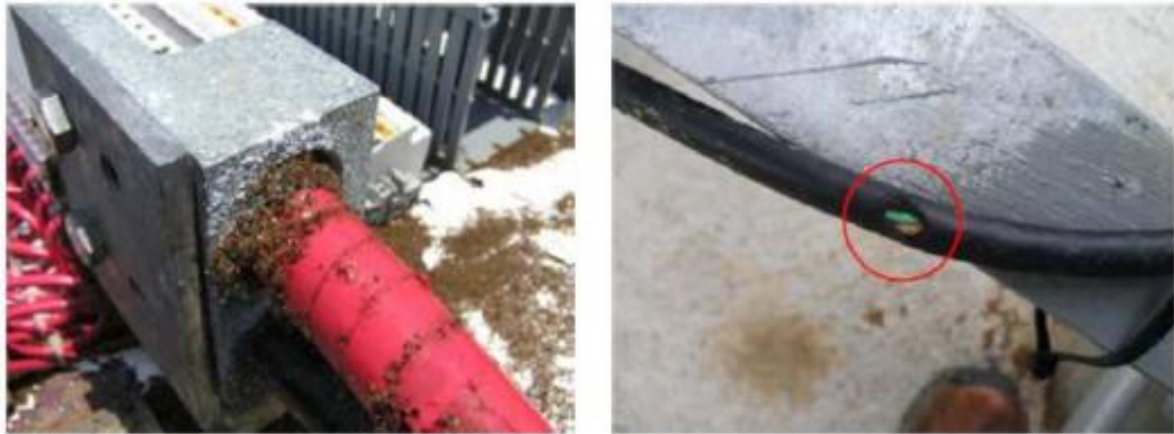
Figure III.4: Exemples de défauts rencontrés dans les câbles
