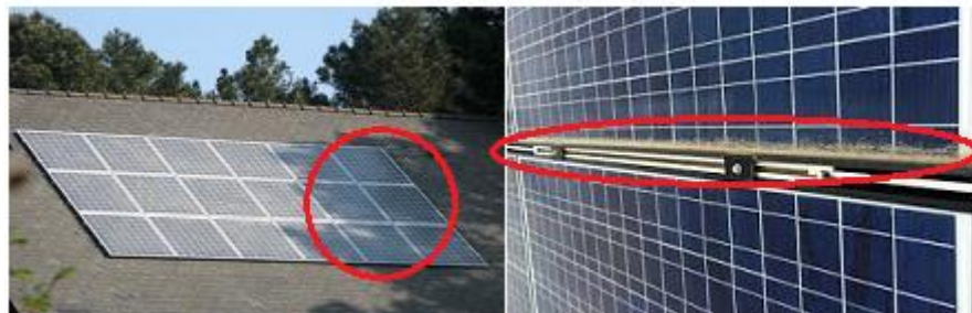
Figure III.2: Exemples de défauts rencontrés dans les générateurs photovoltaïques (Ombrage, Salissure)
