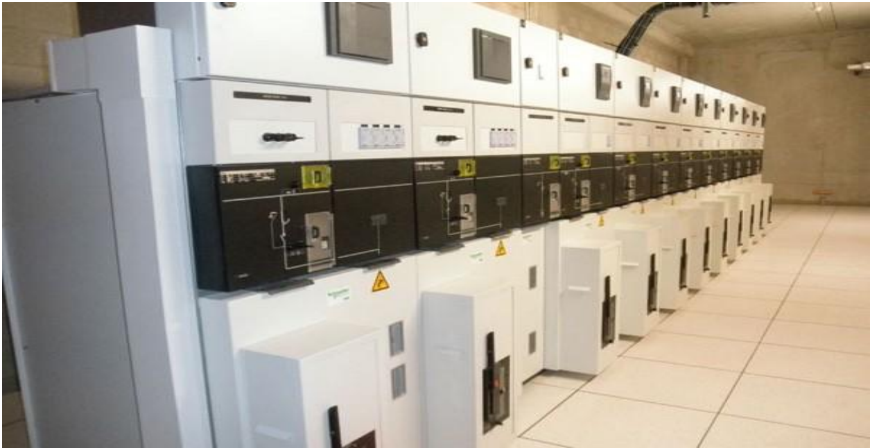
Figure I.11 : Tableau Général Basse Tension (TGBT)
