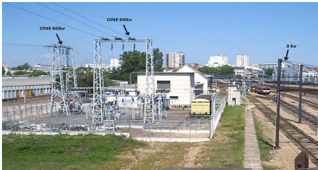
Figure 1.2 Sous-station électrique pour alimenter les caténaires [3]
