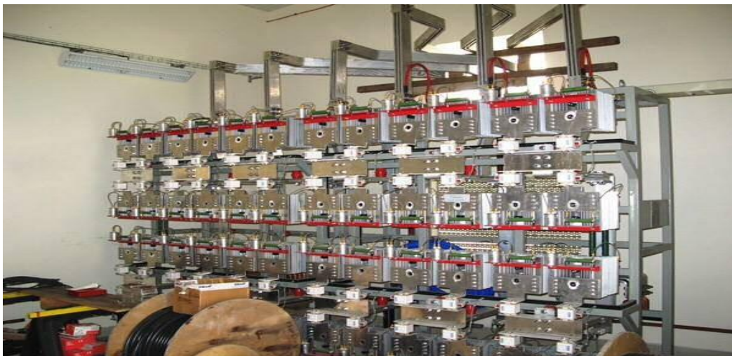
Figure 1.6 Exemple de redresseur utilisé dans une sous-station DC de 1,5 kV [4]
