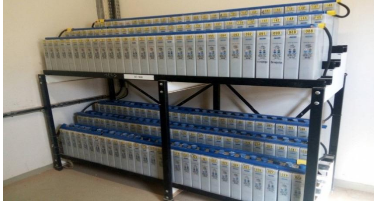
Fig. III. 3. Système de batterie pour notre UPS
