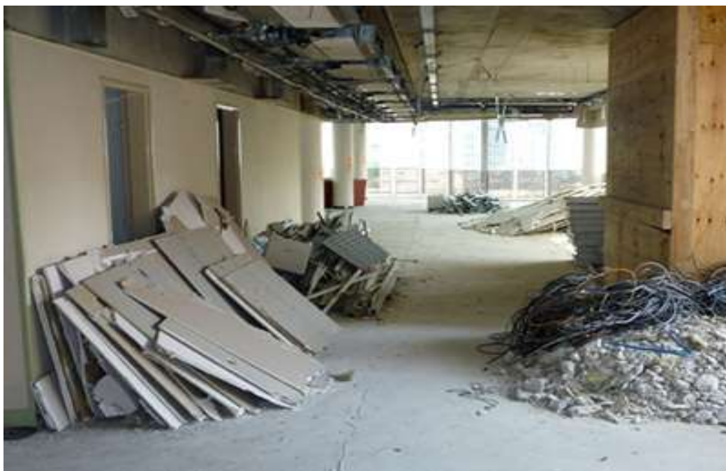
Figure I.13 : Déchets de plâtre sur un chantier de déconstruction.
