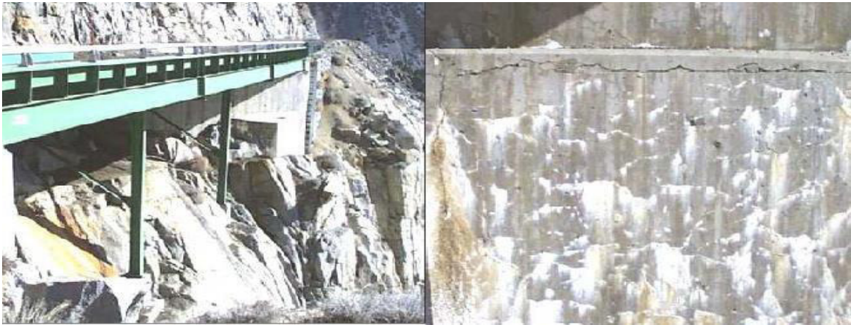
Figure II-1 :Des cas pathologiques d'éléments en béton en contact de sulfate(18).
