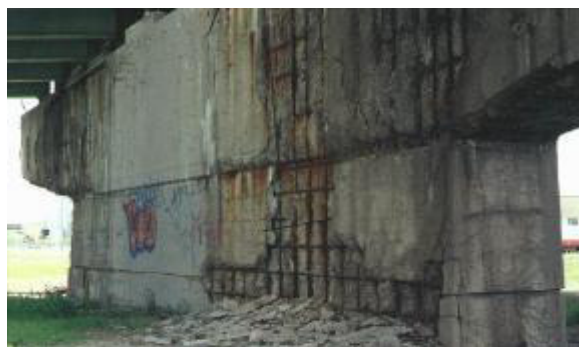
Figure II-5 : Agression du béton par activité des chlorures.
