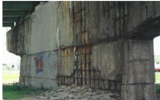
Figure I.2 : Structure atteinte par l'attaque des chlorures [6].
