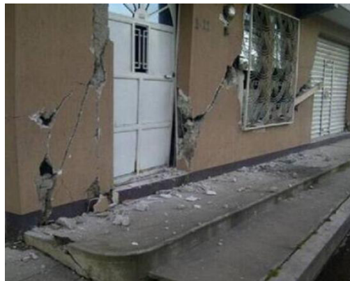
Figure I.7 : Désordres dus au séisme [1] .
