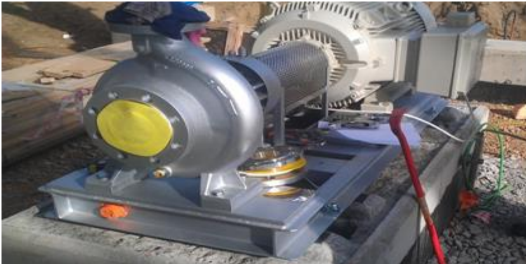
FIGURE I.15 : POMPE DE RECIRCULATION.
