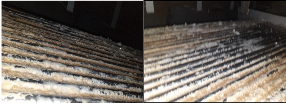
Figure IV 3: Avant nettoyage manuel
