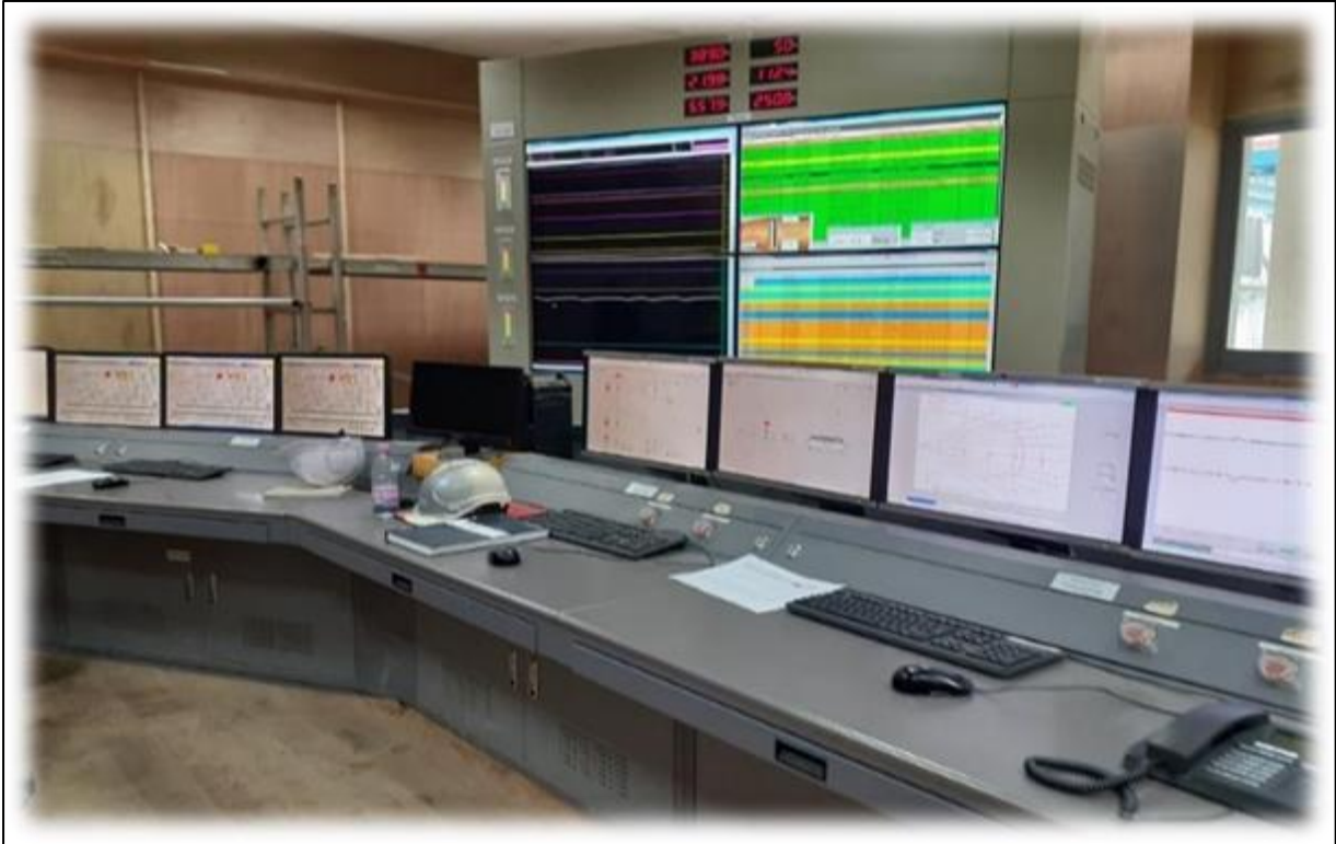
Figure I 12: Salle de commande de la centrale à cycle combiné
