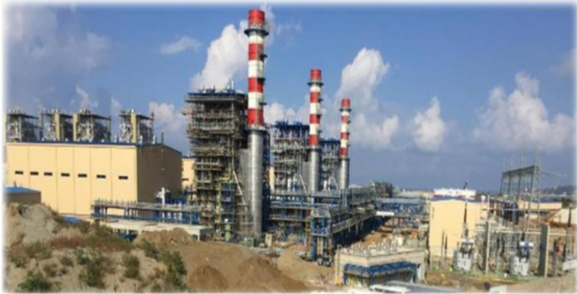
Figure I 3: Station thermique de la nouvelle centrale de RAS-DJINET
