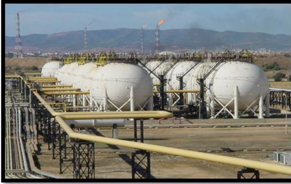
Figure I.2 : Les sphères de stockage
