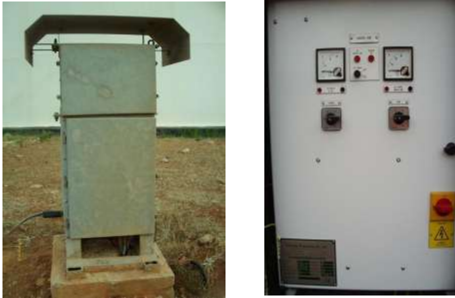
Figure III-5 : Poste de soutirage.
