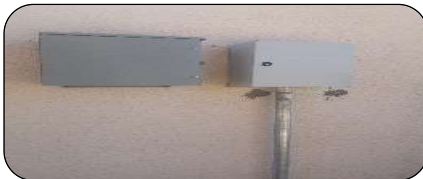
Figure IV-10 : Redresseur et le coffret de jonction.
