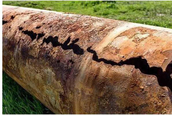
Figure II.7 : Corrosion avec érosion
