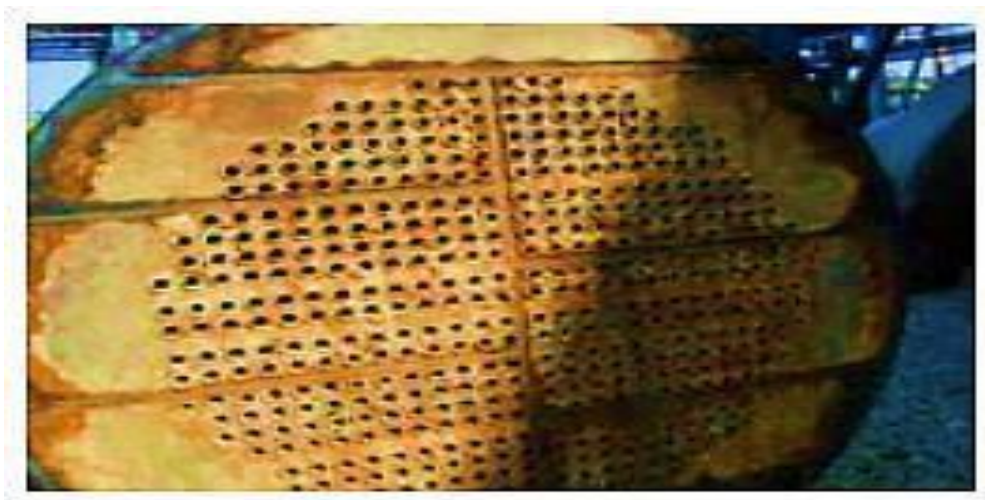
Figure III-17: encrassement dû à la corrosion
