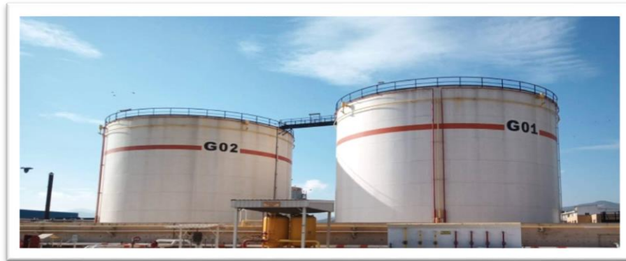
Figure I-4 Réservoir de stockages gas-oil
