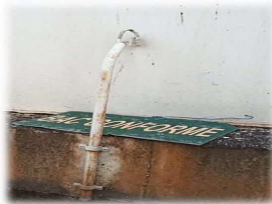
Figure I-9 Mise à la terre
