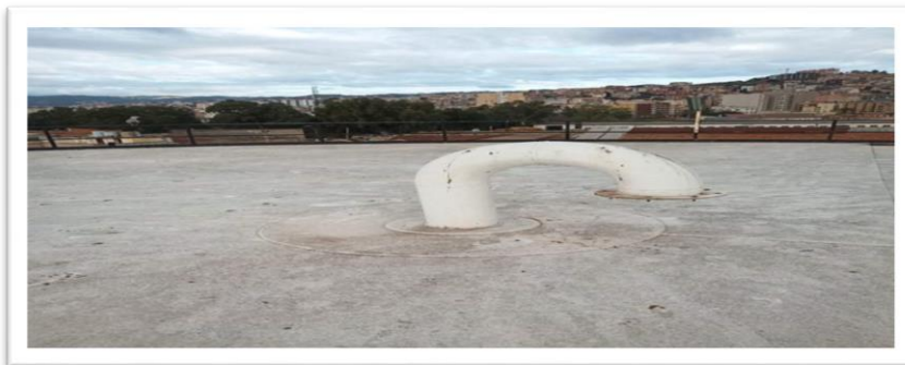
Figure I-4 L'évent d'un bac
