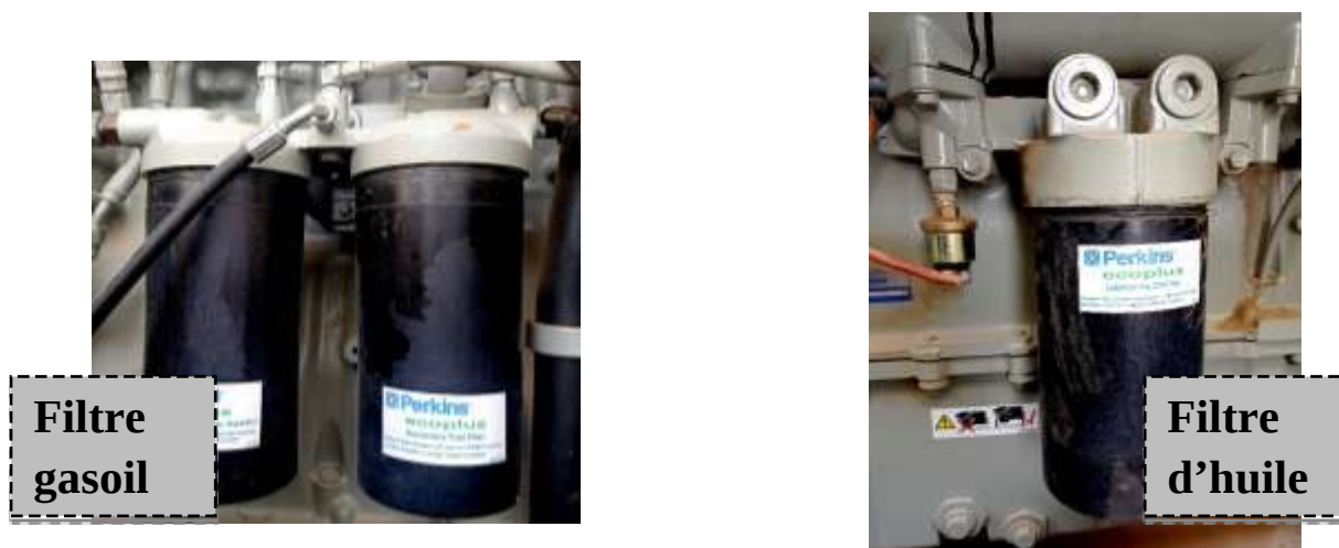
Figure III.24 : filtres a huile & gasoil
