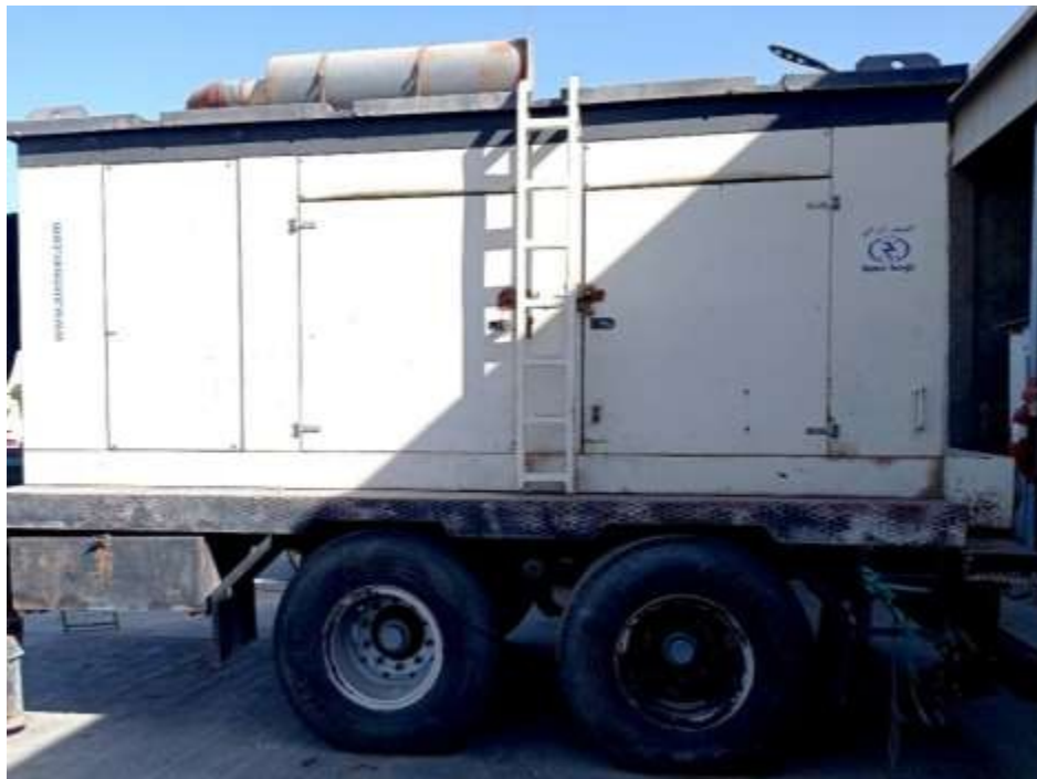
Figure III. 5: Groupe électrogène mobile Diesel Amimer énergie 500KVA
