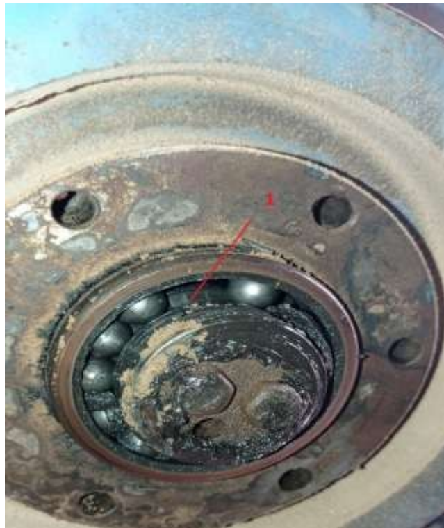
Figure 3. Etat du roulement du ventilateur
