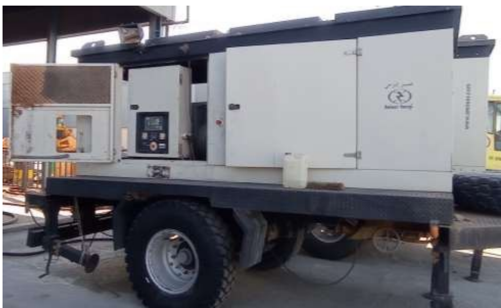
Figure III. 4: Groupe électrogène mobile Diesel Amimer Energie 110KVA
