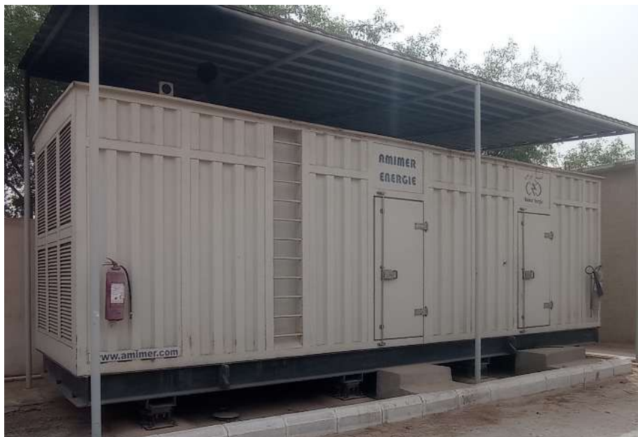
Figure III. 7: groupe électrogène stationnaire Diesel en conteneur 1500KVA
