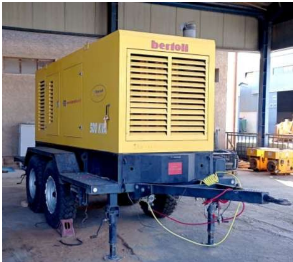
Figure III. 1 : Groupe électrogène Diesel mobile 500 KVA BERTOLI
