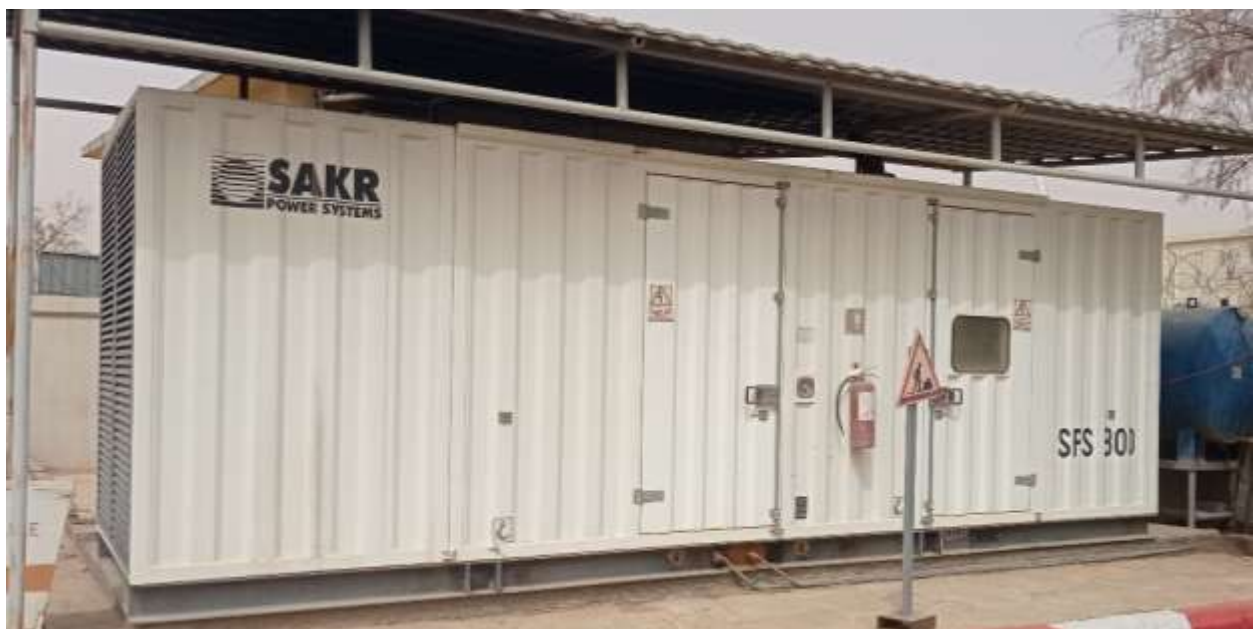
Figure III. 6: groupe électrogène stationnaire Diesel en conteneur 800KVA
