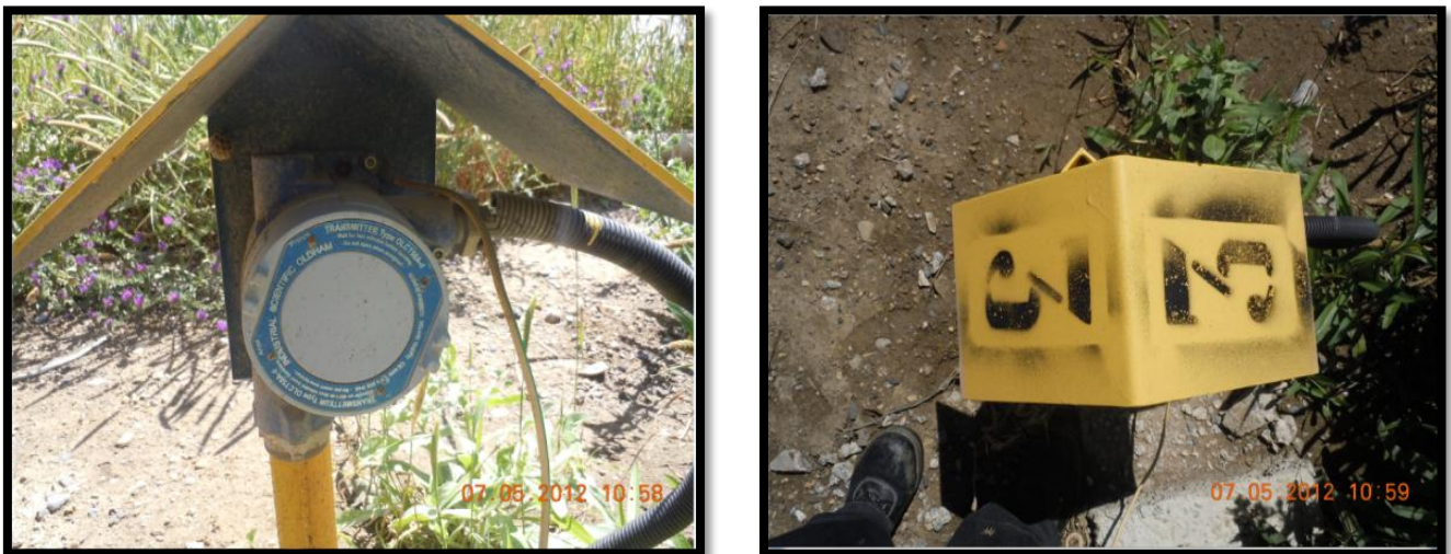
Figure 43: Détecteur de gaz
