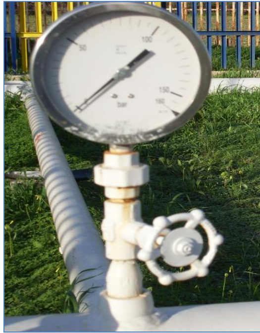
Figure III.2 : Manomètre au niveau de la pipe.
