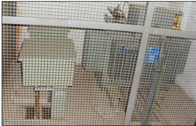
Figure II.22: Transformateur de courant 5500 V.
