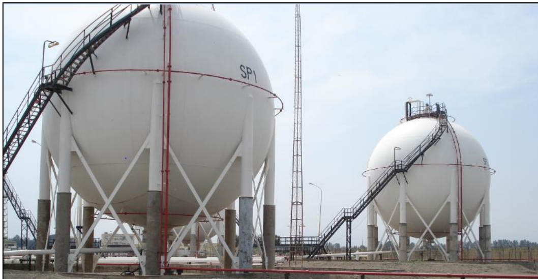
Figure II.5: les deux sphères Propanes SP.
