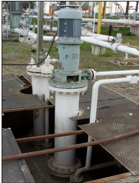
Figure II.8 : pompe de recyclage.
