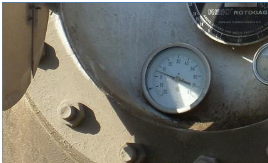
Figure III.3 : Manomètre au niveau de la citerne.
