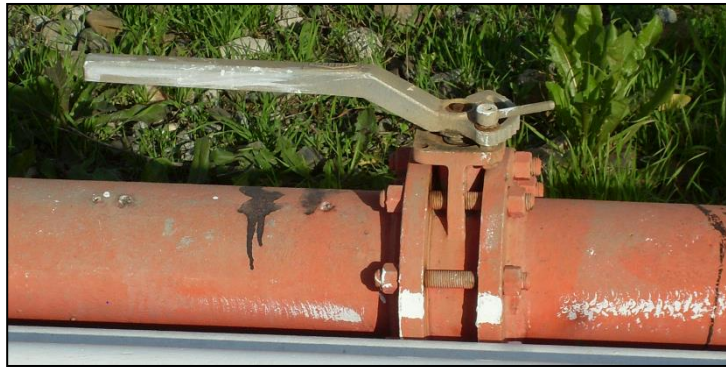
Figure II.15 : Vanne de sectionnement.
