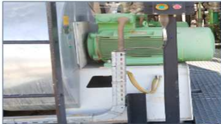
Figure I. 15 La soufflante d'air K301A/B.
