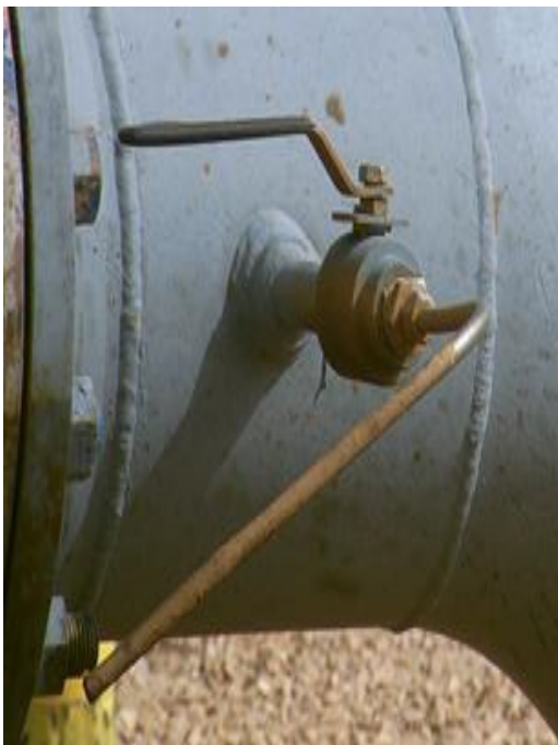
Figure 8 : purge de prise d'échantillon
