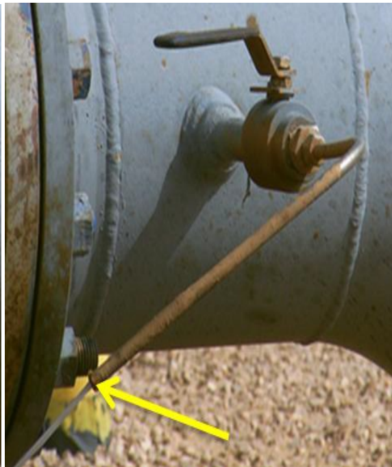
Figure 9 : purge ouverte à fort débit
