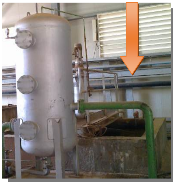
Figure 6 : La cuve de floculation
