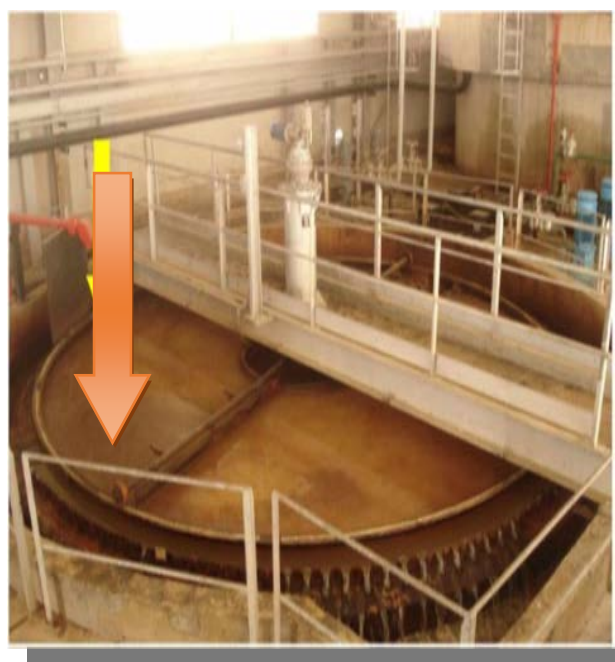
Figure 7 : La cuve de flottation
