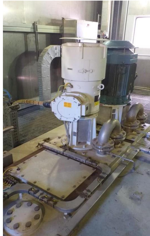
Figure II-13 : pompe de secours
