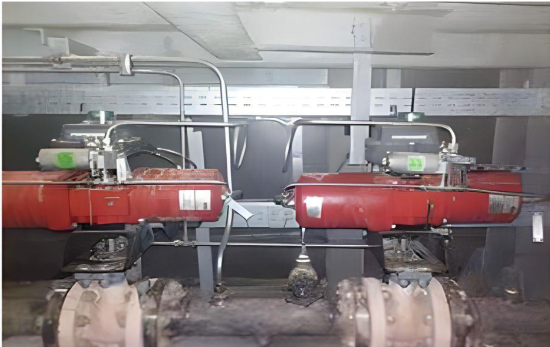
Figure III-10: Vannes de purge avec détendeur
