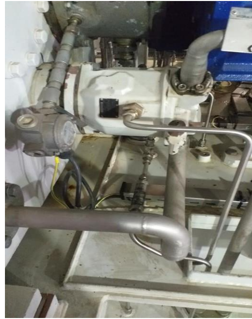
Figure II-14: pompe hydraulique auxiliaire
