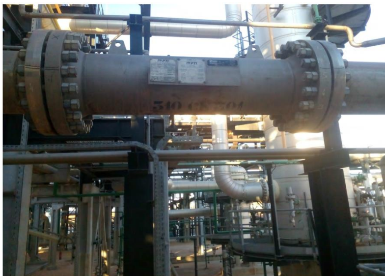
Figure 36 : Le mélangeur statique de gaz entré (310-CE-301)
