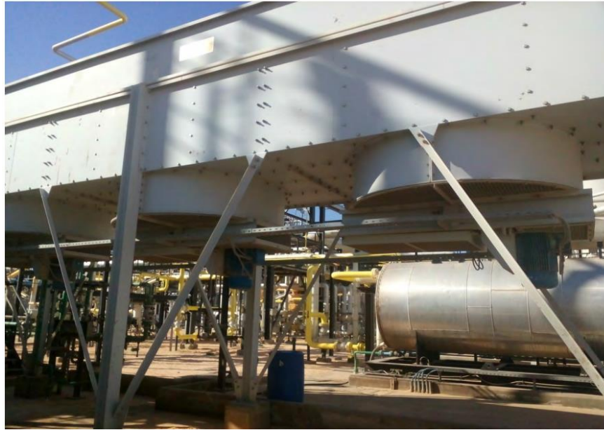
Figure 43 : Le réfrigérant final du glycol
