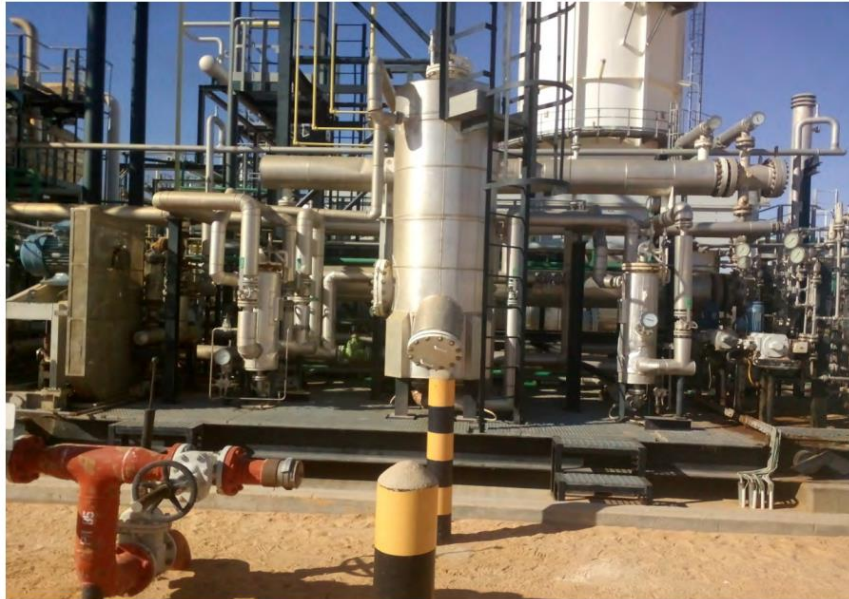
Figure 40 : Les deux filtres à glycol et le filtre à charbon au milieu.
