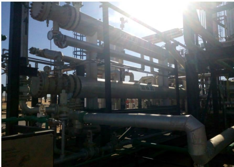
Figure 41 : L'échangeur de glycol avant flash au-dessus et l'échangeur après flash au-dessous.
