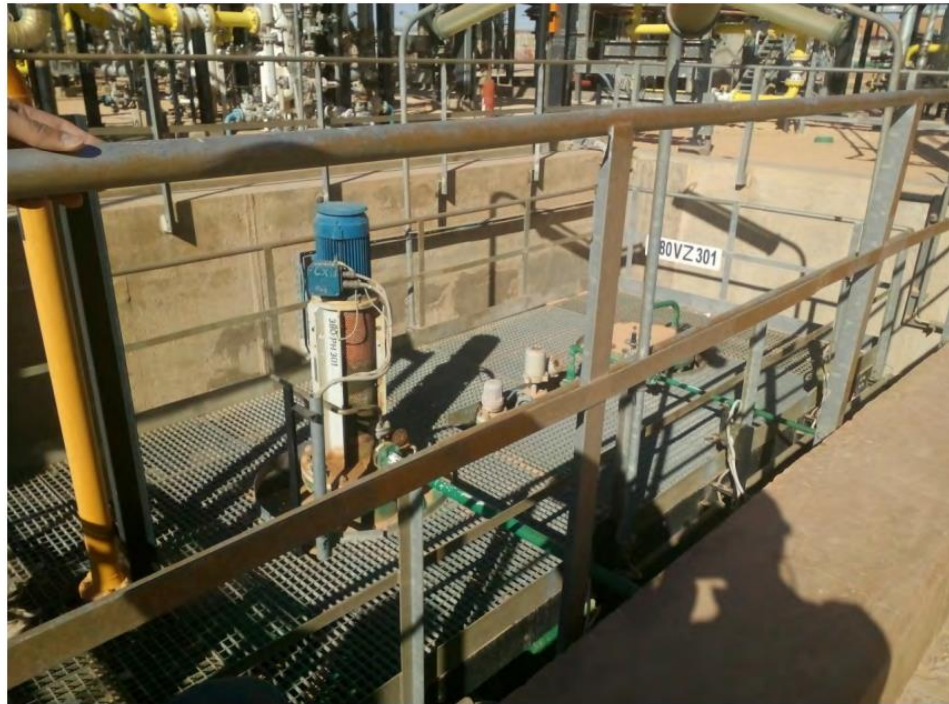
Figure 45 : Système des drains de glycol.
