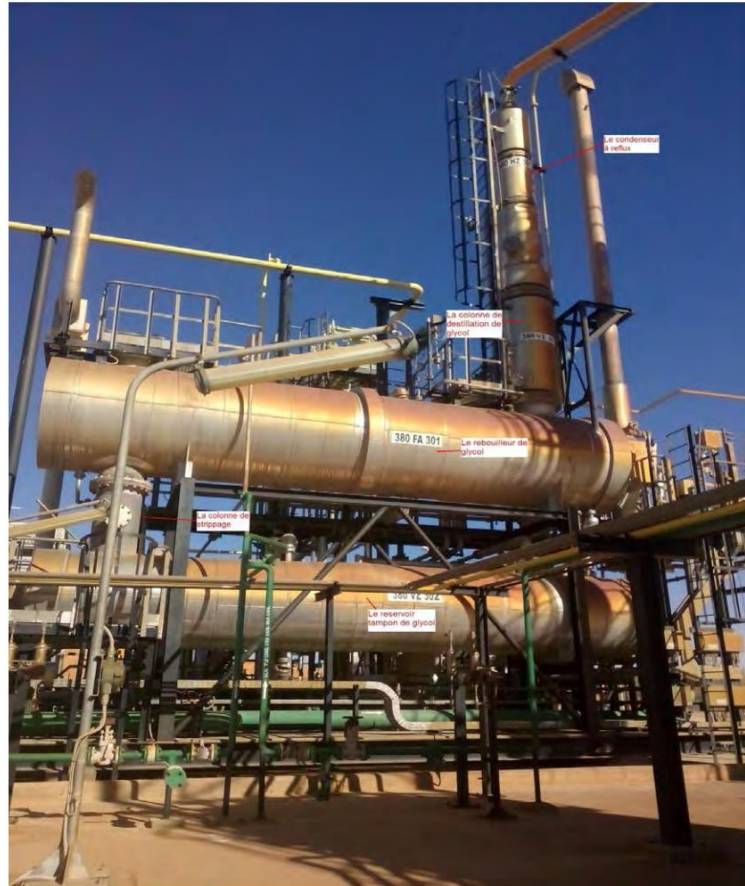
Figure 42 : Le régénérateur de glycol (l'échangeur submergé, la colonne de distillation, le rebouilleur, la colonne de stripage et le réservoir tampon.
