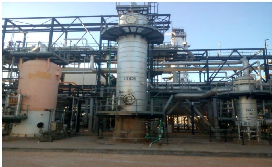
Figure 37 : De gauche à droite le Ballon du contacteur, le Contacteur de glycol et le Coalesceur du glycol
