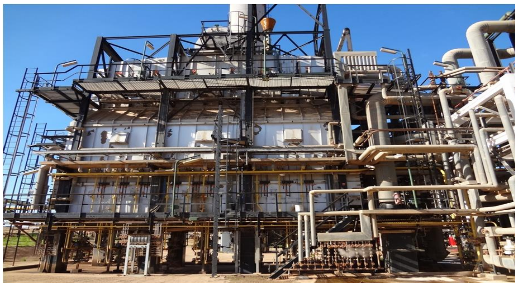
Figure IV.1 Four H101 de l'unité 100 de la zone 5. (Four de type cabine)
