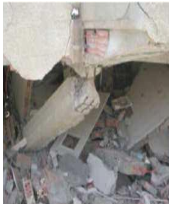
cisaillement du poteau et l'absence du confinement
