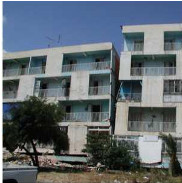
Effondrement total du R.D.C
