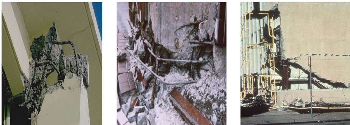
Photo 1.8 : Rupture des zones critiques [1]
