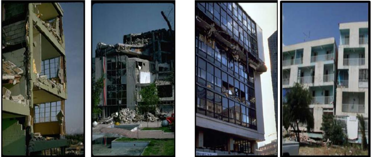
Désolidarisation des façades, destruction des étages supérieurs, intermédiaires ou inférieurs
