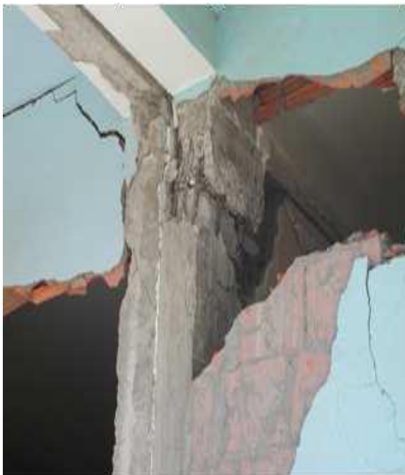
Eclatement des panneaux de maçonnerie
