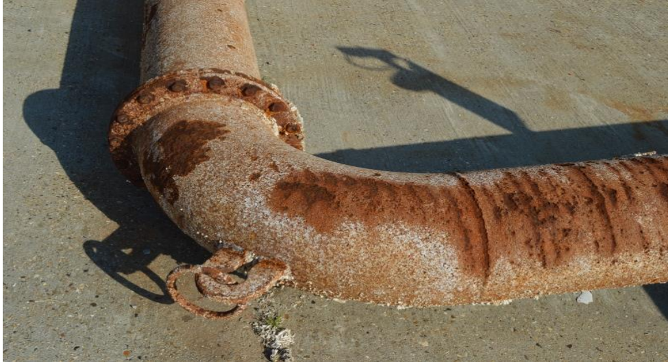
Figure 1.7: Une conduite usée par corrosion
