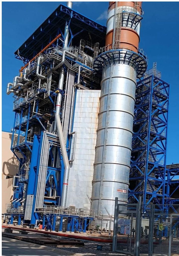
Figure I-5 : Vue d'extérieur de la GVRC de la centrale à CC de Ras-Djinet
