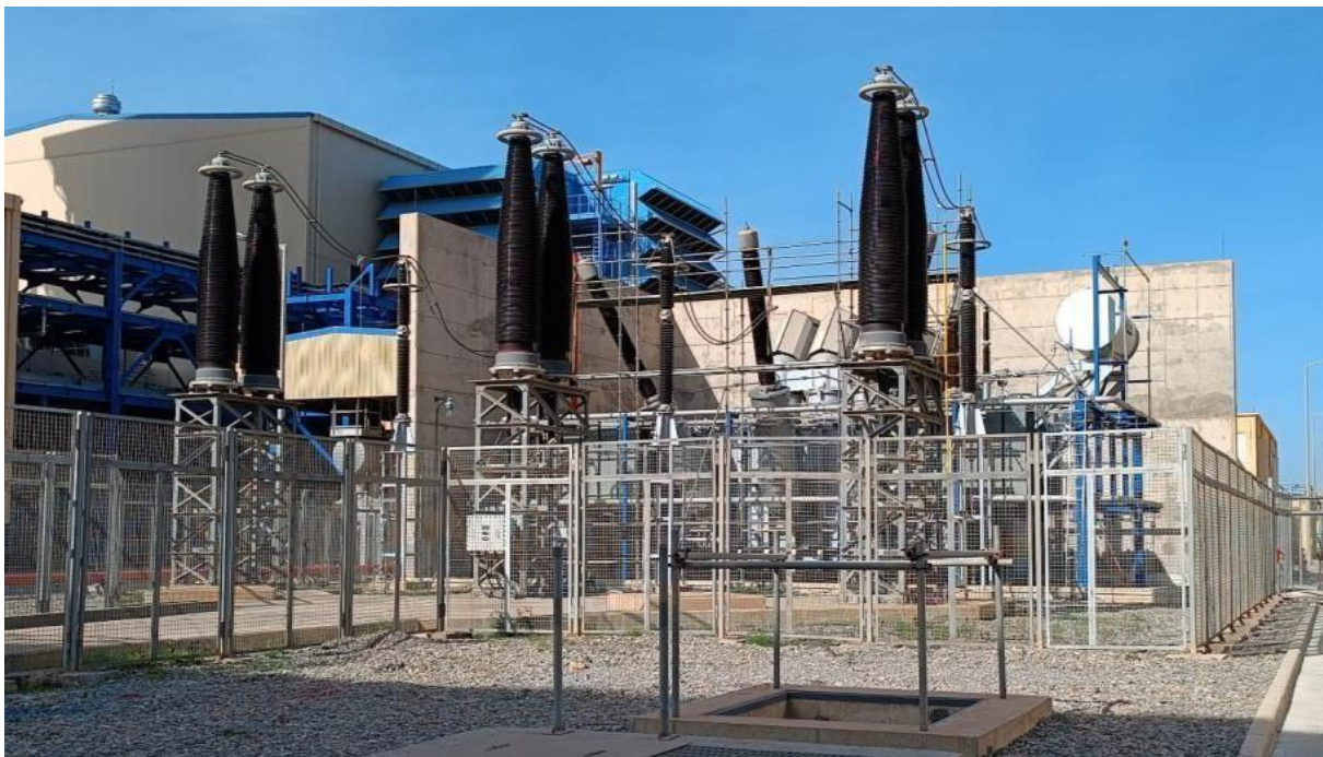
Figure I-9 : Vue d'extérieur du transformateur
