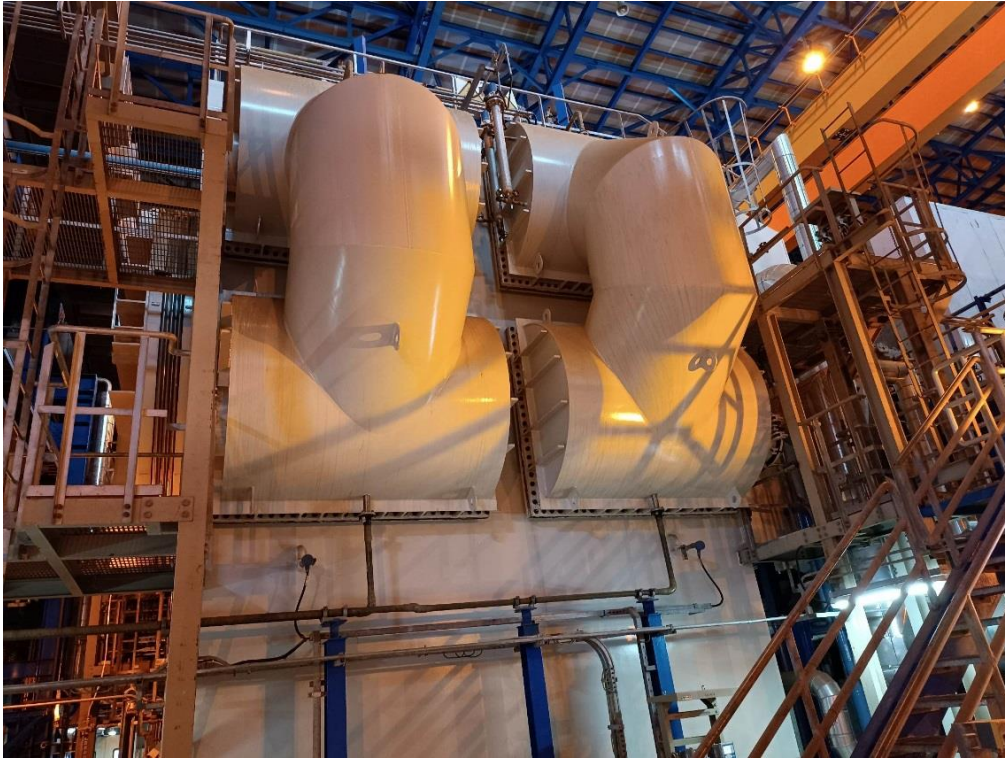
Figure I-7 : Vue de l'extérieur du condenseur (MAG10AC001)
