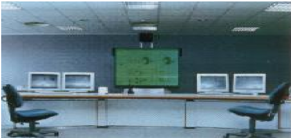
Figure I .3 : Salle de commande.
