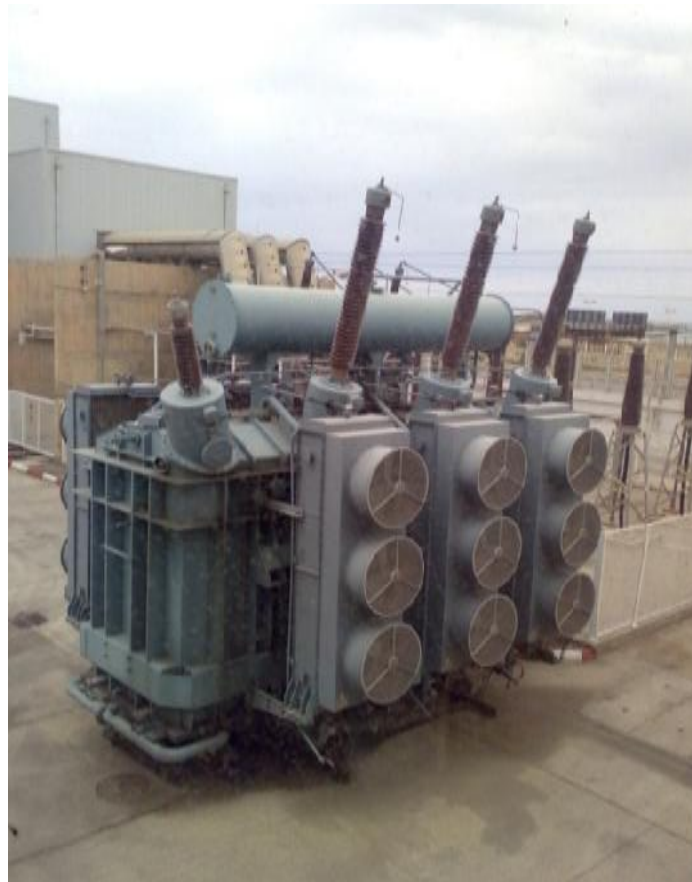
Figure. I.6 : Vue externe de transformateur principal.
