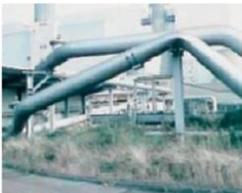
Figure II.5 : Tuyauterie de pression DN 600 totalement détruite (épaisseur de paroi 12 mm).
