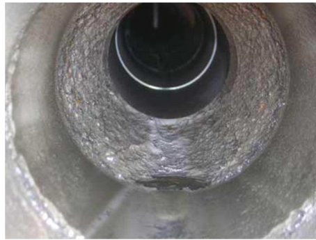
Figure 1.3 : Perte de métal due à l'érosion par le sable
