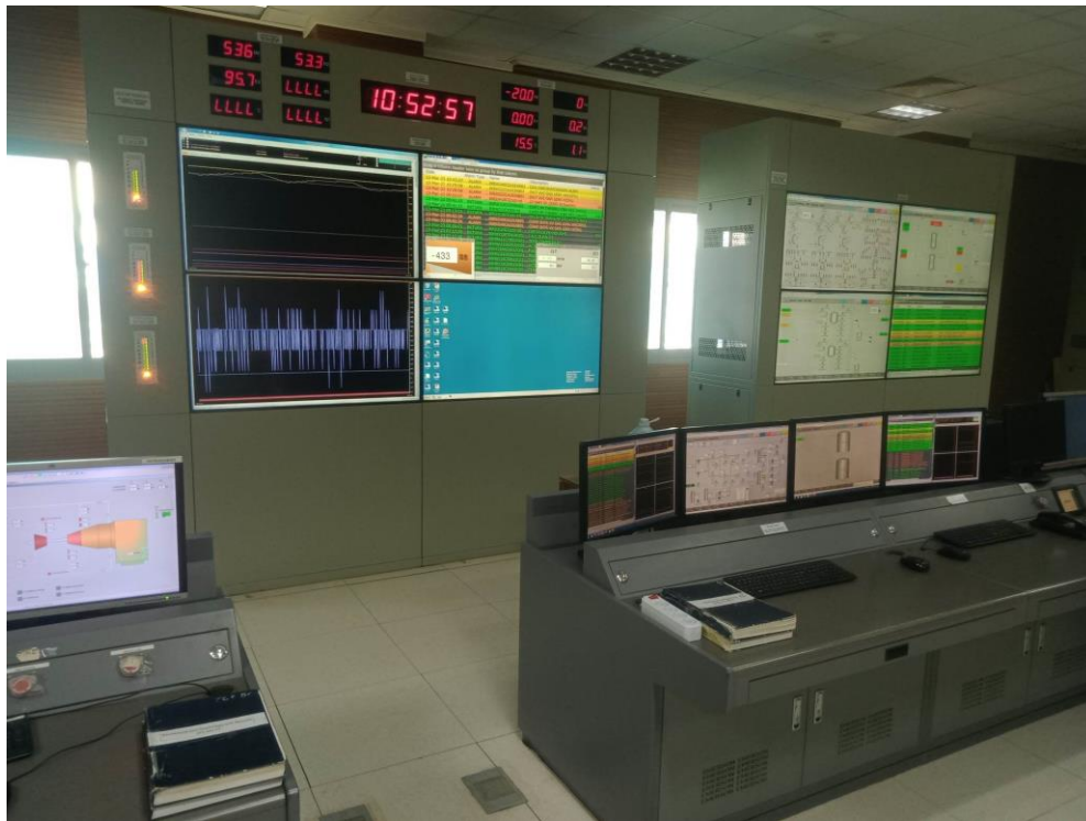
Figure I.7 : Salle de commande de la centrale à cycle combiné
