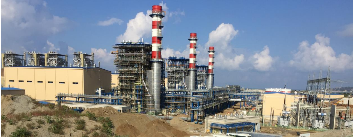
Figure I.3: Station thermique de la nouvelle centrale de RAS-DJINET
