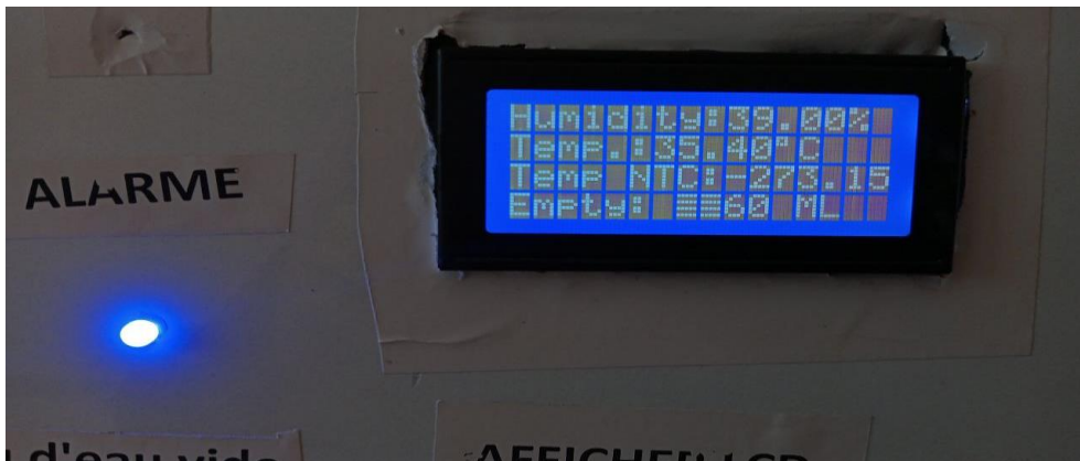
Figure IV. 15 : Signalisation niveau d'eau bas
