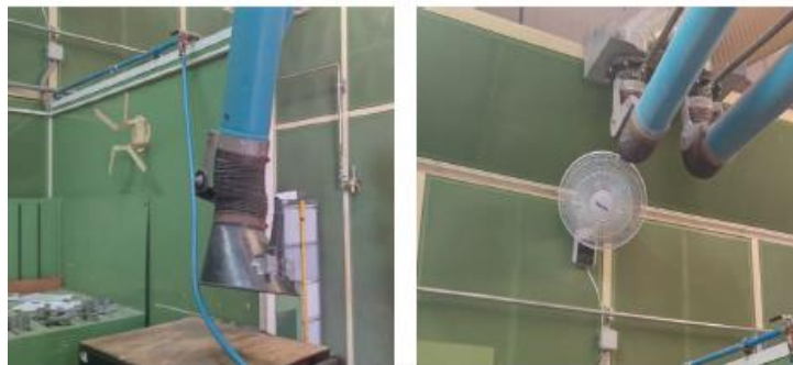
Figure 1.34 : système de ventilation
