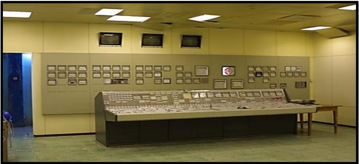
Figure I.9 : salle de commande.
