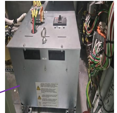
Coffret de batteries
