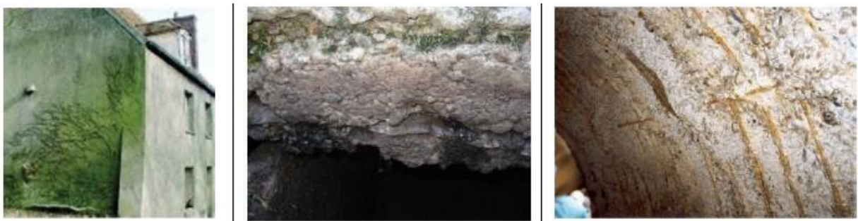
Figure I-14 : Bioaltération d'une facade , d'une dalle d'une fosse et d'un collecteur.
