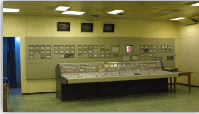
Figure I-7 : Salle de commande
