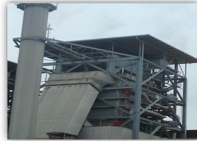
Figure I-2: Générateur de vapeur
