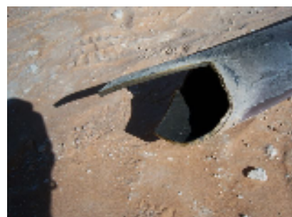
Photo-4 : Conduite détruite (EMK-34)
