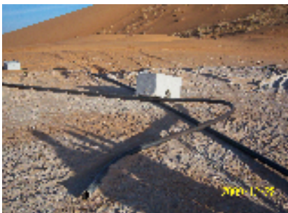
Photo-3 : Destruction de la conduite (EMK-34)
