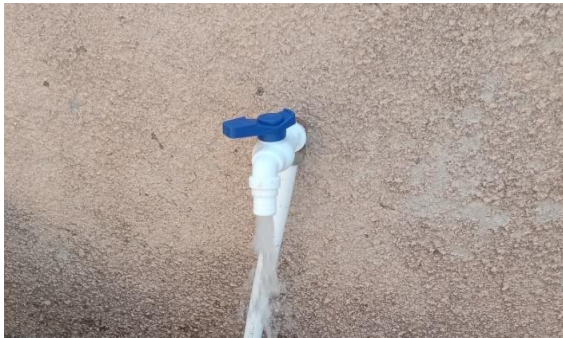
Figure 47 : Photo de l'arrivée de l'eau du réseau.
