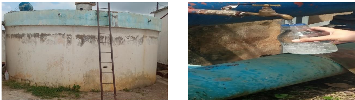
Figure 22 : Photo de réservoir SR 01 Djalloula.
