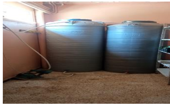
Figure 48 : Photo des citernes.
