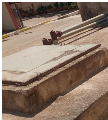
Figure 33 : Photo de la bache à eau.
