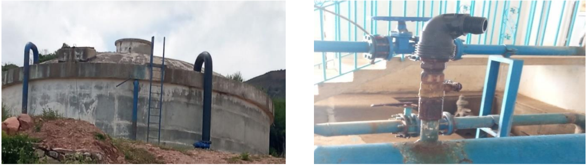
Figure 23 : Photo de réservoir SR 02 Bennourah.
