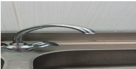
Figure 37 : Photo de l'arrivée d'eau.
