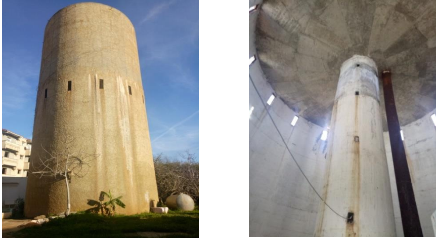
Figure 26 : Photo du château d'eau Hlaimia 500 m 3 .
