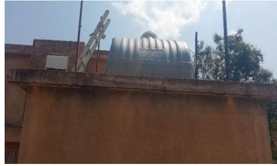
Figure 35 : Photo de l'arrivée d'eau.
