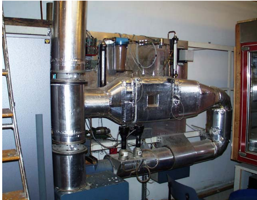
Figure 4.2 : Vue d'ensemble de l'échangeur de chaleur.
