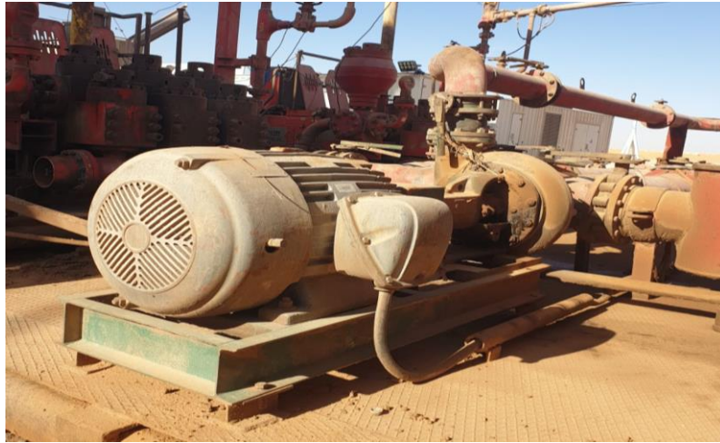
Figure 1.2 : Pompe de suralimentation de l'appareil de RIG ENF#61.
