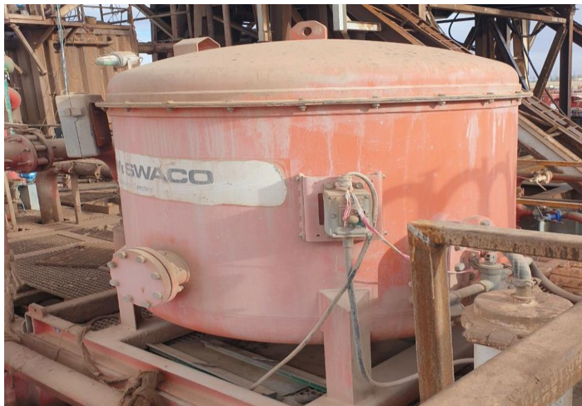
Figure 1.6 : Dégazeur de boue de RIG ENF#61.
