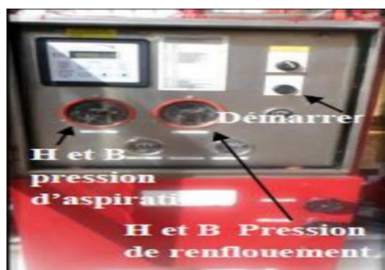
Fig (1.7) : Panneau de contrôle
