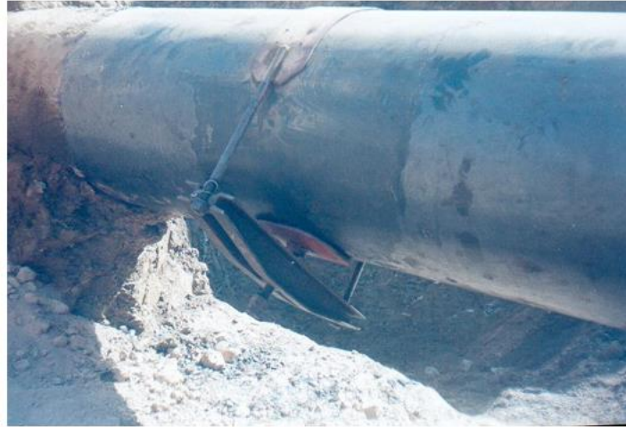
Figure VI.4.4: fuite étanchée par la pose d'une rustine maintenue par un collier
