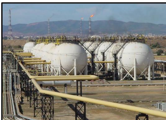
Figure I-17 : Sphères de stockage.
