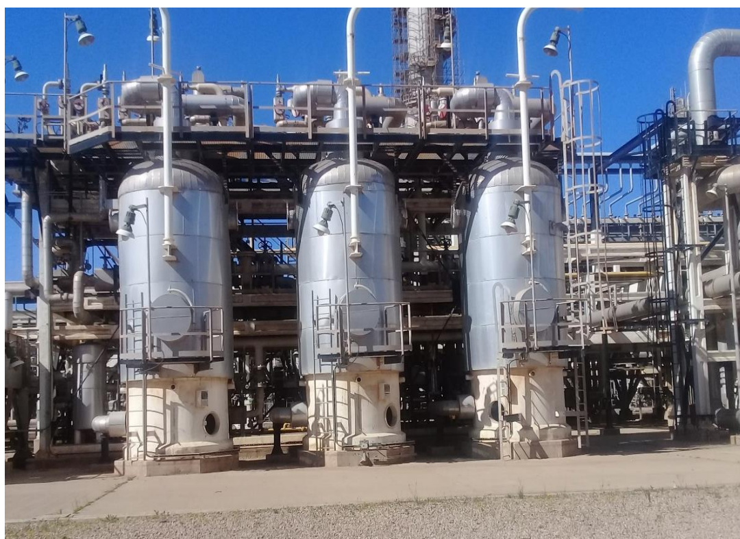
Figure 0-8 : Colonnes de déshydratation.
