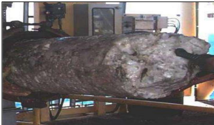
Figure III-2 : Accumulation des hydrates dans une conduite (source Petrobras, Brasil).
