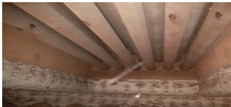
Figure 3-12 : Les tubes nus de la rampe de décharge Four RA2/K
