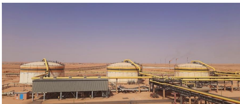
Figure 4-2 : Bacs de stockage de condensat au niveau du module 4 Hassi-Rmel
