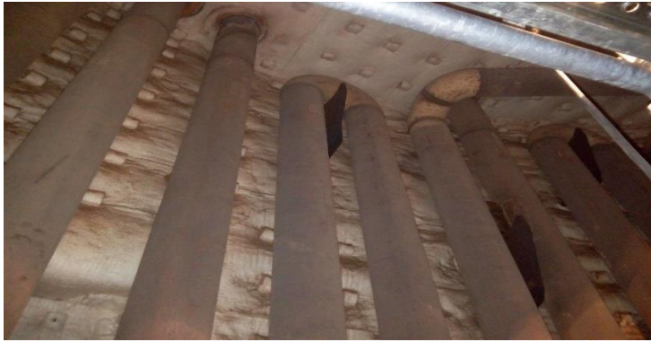
Figure 3-6 : Aperçu des supports de tubes dans la zone de radiation Four RA2/K
