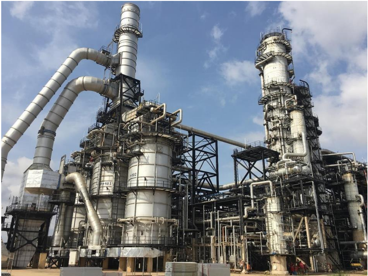
Figure 7-1 : Image réelle des fours et du préchauffeur d'air de l'unité 100
