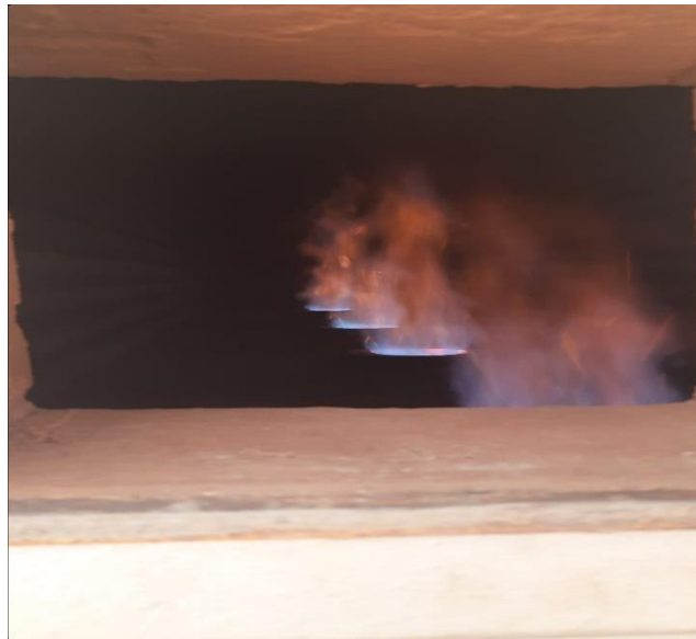
Figure 3-7 : Bruleurs de four du module 4 Hassi-Rmel
