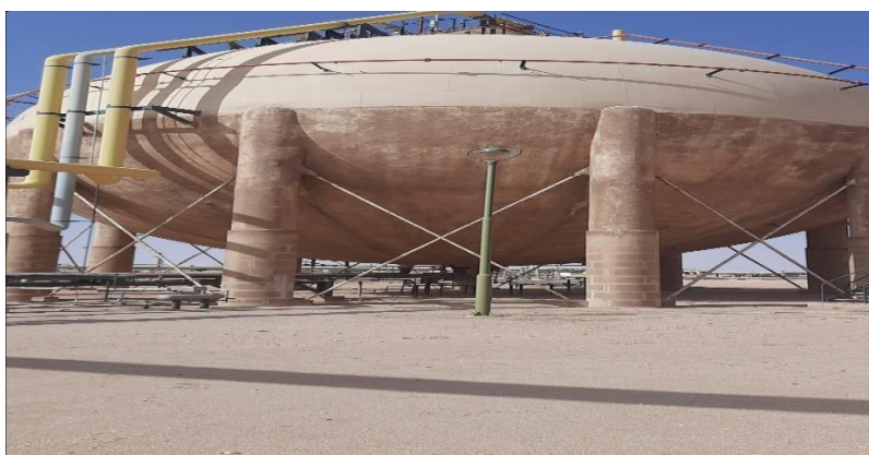
Figure 4-3 : Sphère de stockage de GPL
