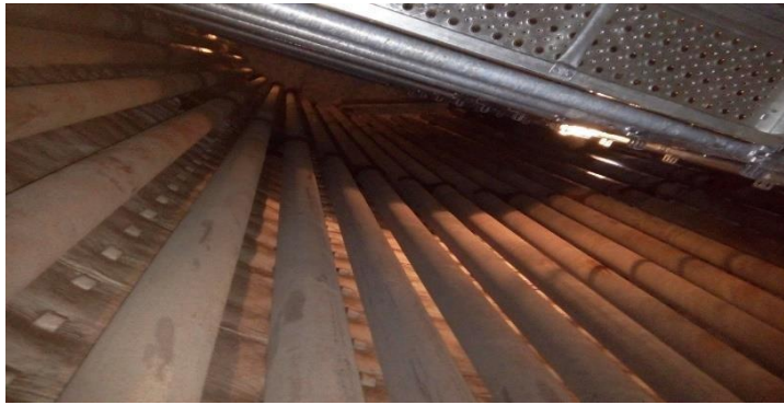
Figure 3-4 : Un faisceau tubulaire dans la zone de radiation Four RA2/K
